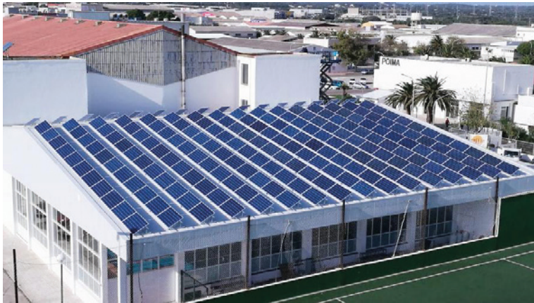
Fig. 1. Instal·lació fotovoltaïca per a autoconsum del poliesportiu municipal de Maó. Novembre 2017.
