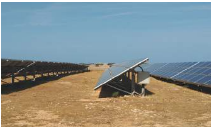
Panells fotovoltaics de Son Salomó.
